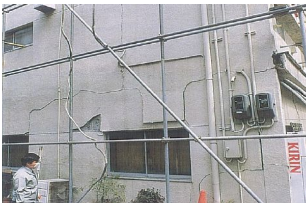
阪神・淡路大震災におけるアロンウオール塗布外壁の状況
