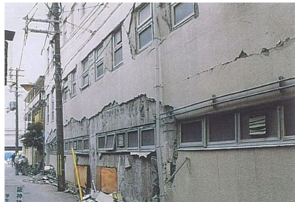
阪神・淡路大震災における一般的な外壁の状況
